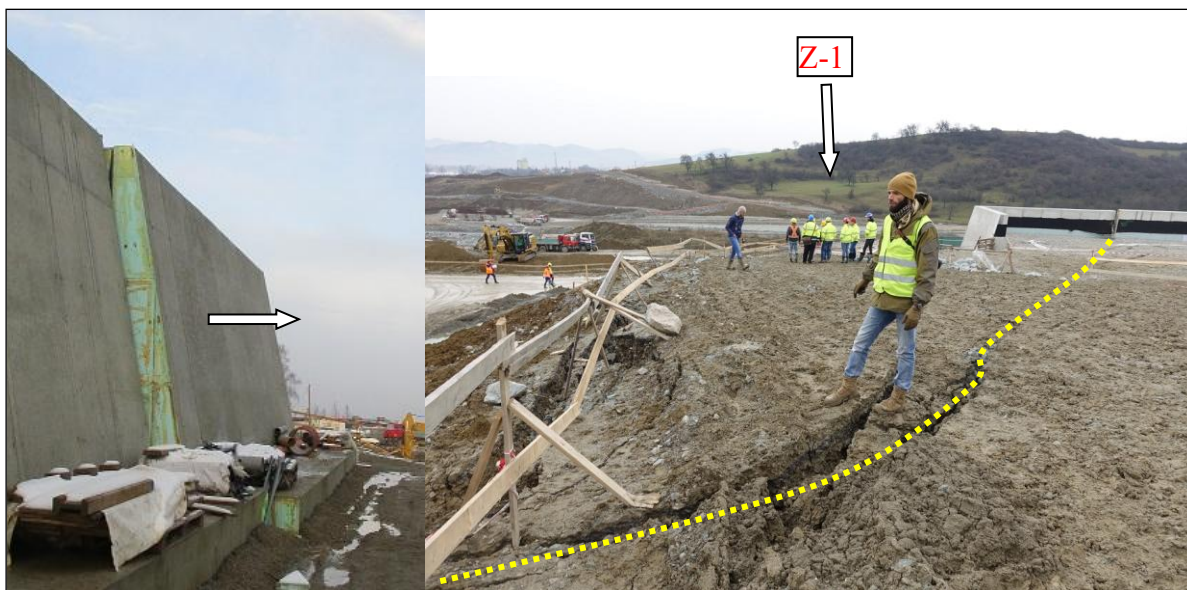
Obr.5 Posunutie múra a ohraničenie zosuvu ZK-2 nad múrom – v pozadí zosuv Z-1.
