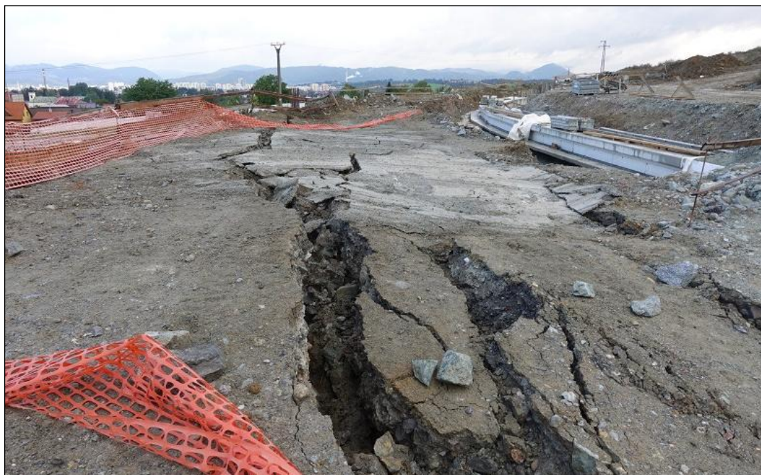
Obr. 8 Odlučná hrana zosuvu ZK-3 pri pilótovej stene Fig. 8 Main scarp of the ZK-3 landslide near the pile wall.
