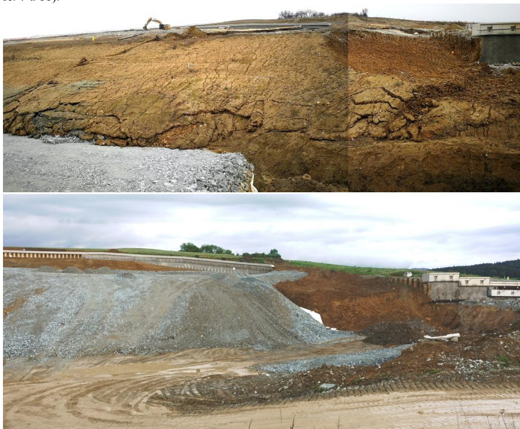
Obr.10 Stav zosuvu ZK-4 1.12. 2018 horný obrázok a stav po sanácii v roku 2020 Fig. 10 ZK-4 landslide on 1 December 2018 (top) and after remediation in 2020 (bottom).
